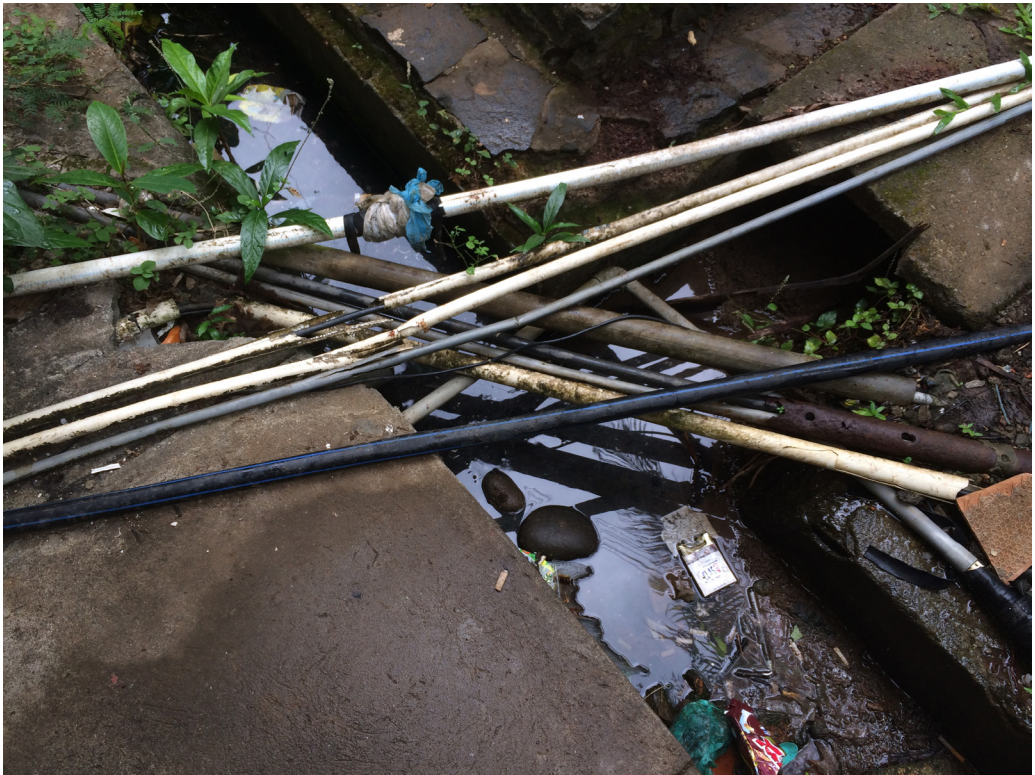
Gambar 41. Pipa air bersih yang dipasang tumpang-tindih dengan kabel-kabel jaringan listrik, telpon, dan internet di selokan Gedung Rektorat
