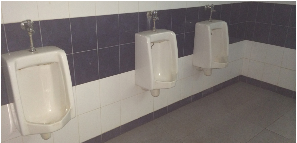
Gambar 30. Urinoir dilengkapi dengan keran pembilas, dipasang menggantung pada dinding ruangan
