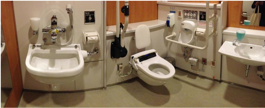
Gambar 39. Toilet untuk pengguna difabel di Bandara Tokushima Sumber: Koleksi Iqbal Djawad
