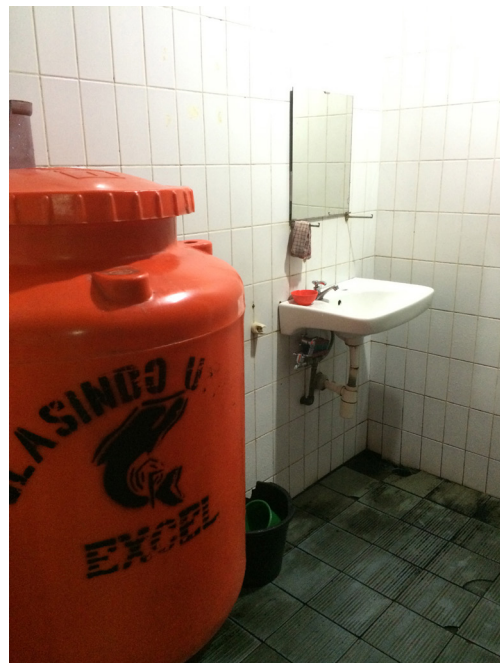
Gambar 38. Contoh tangki air dari PVC yang ada di hall-hall toilet
