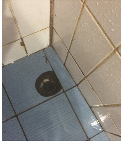
Gambar 43. Lubang pembuangan pada lantai tanpa penutup lubang pipa ( floor drain )
