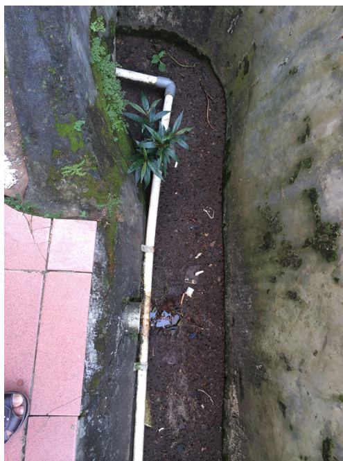
Gambar 40. Mulut pipa saluran air kotor dari sentra toilet yang berhadapan langsung dengan pipa air bersih yang mengalami kebocoran
