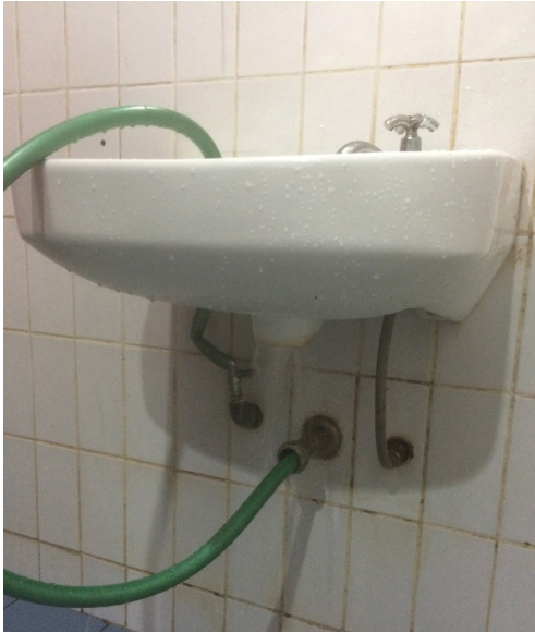
Gambar 42. Mulut pipa saluran air kotor dari sentra toilet yang berhadapan langsung dengan pipa air bersih yang mengalami kebocoran
