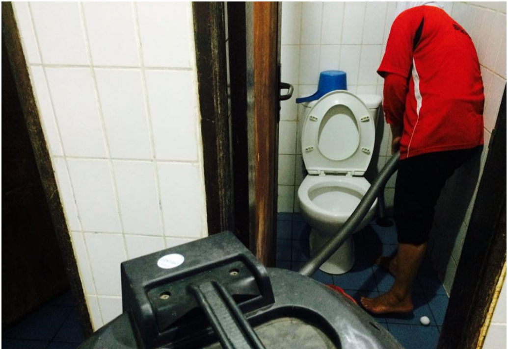
Gambar 44. Petugas kebersihan menyodok dan menyemprot lubang floor drain yang buntu dengan pipa vacuum cleaner
